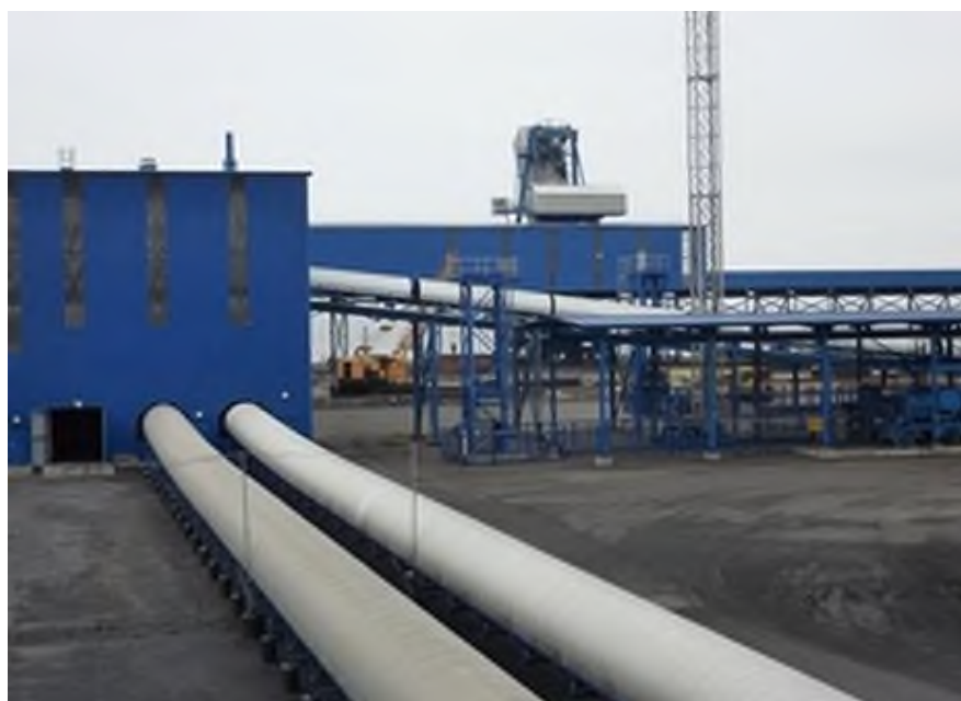
Рисунок 55 – ТКС с полностью закрытыми конвейерами
